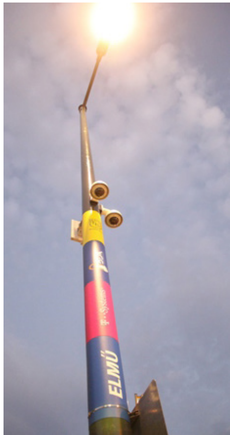
Intelligens közvilágítási oszlop
