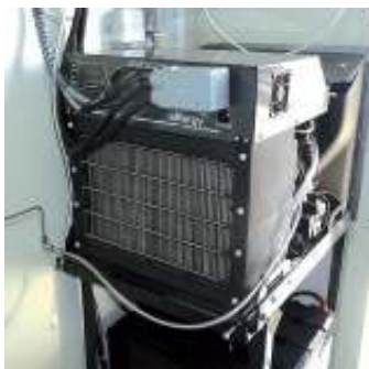
Alternatív energia (PEM-cella (6 db))
