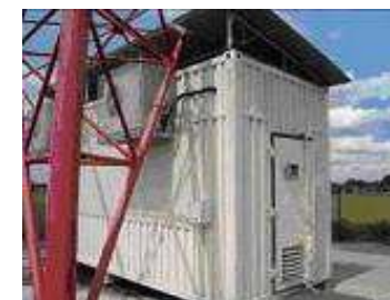
Klímaberendezés (950 bázisállomás szabadlevegős hűtése)
